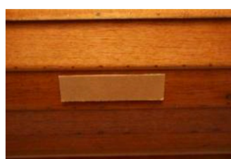
Ein Stück Pappe, Holz oder der Teil eines Fahrradschlauches wird zum Abdecken des Risses verwendet.
