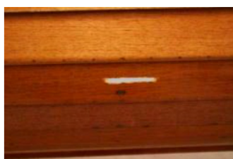
Der Riss ist lokalisiert
